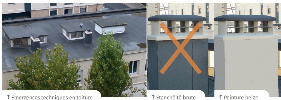
↑ Émergences techniques en toiture
